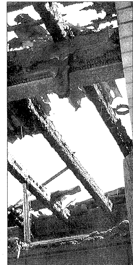
Vom Dach ist nicht viel übrig geblieben: Das Feuer zerstörte die obere Etage komplett.
