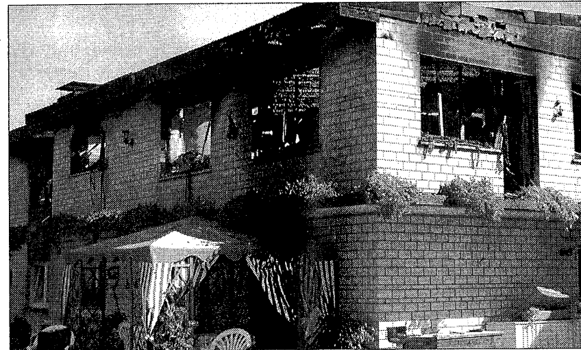
Die obere Etage und der Dachstuhl eines Wohnhauses in Niederbusch fielen den Flammen komplett zum Opfer. Fotos: Georg Schmitz
